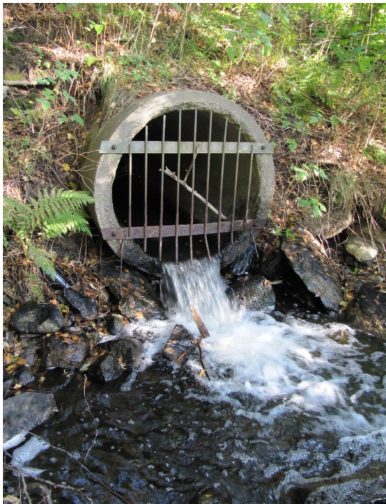
Figur 1 Fritt fall och/eller galler innebär vandringsstopp och är en felaktig utformning (Foto och bild Emil Nilsson).
