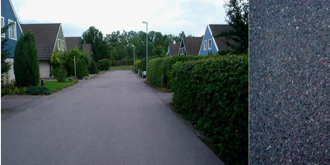
Figur 31: ABT – tät asfaltbetong. Stenmateriallets ljushet är av mindre vikt eftersom stenar på ytan endast förekommer i mindre omfattning. Bild: VGU 2004.
