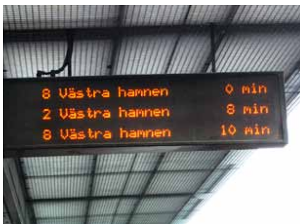
FIGUR 5-17. Dynamisk skylt med realtidsinformation på hållplats i Malmö.
