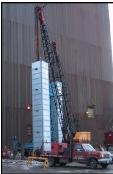
Figur 4: Avskärmning för pålning, exempel 1 (U.S. Department of Transportation - Research and Innovative Technology Administration, 2006)
