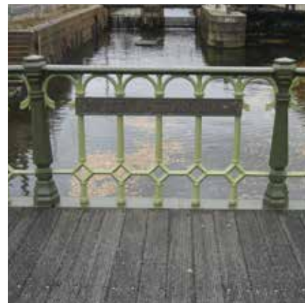
Drottningtorgsbron. Stolpar och överliggare i mörkt gultonad grön och fyllning i ljust gultonad grön.
